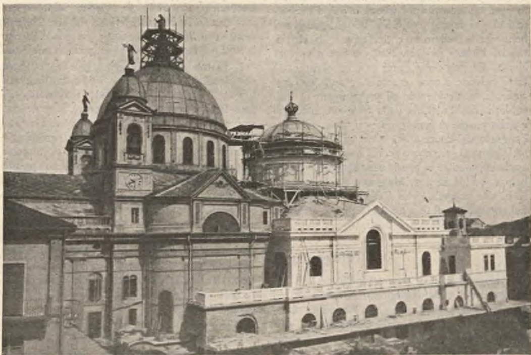
Torino. - Ampliamento della Basilica di Maria Ausiliatrice. Lo stato dei lavori al 1° luglio.
